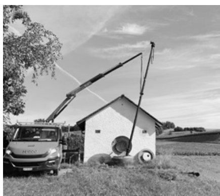
Ansaugleitung Pumpwerk Vordergrüt
