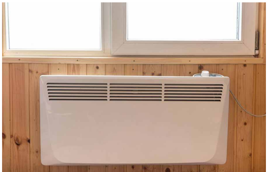
Elektroheizungen sind Stromfresser. Sie müssen bis 2030 ersetzt werden.
