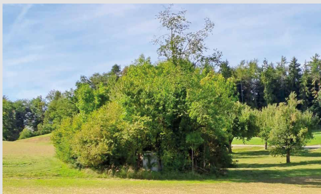
Das baufällige Reservoir auf der Parzelle «Rietliacker».
