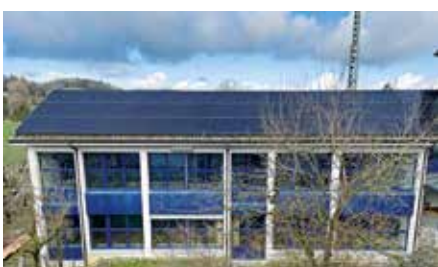
Fensterfront mit Sanierungsbedarf beim Primarschulhaus. Bild: Jens Beer
