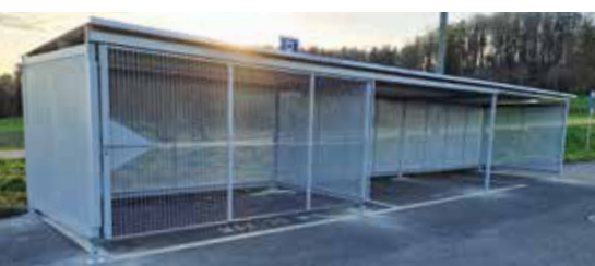
Abschliessbare Veloabstellanlage beim Bahnhof Dinhard. Bild: Silas Gerber
